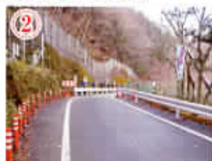
崩落により法面対策工事が行われている(高萩付近)
