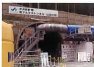
工事が進むリニア中央新幹線南アルプストンネル(平成29年5月早川町内)
