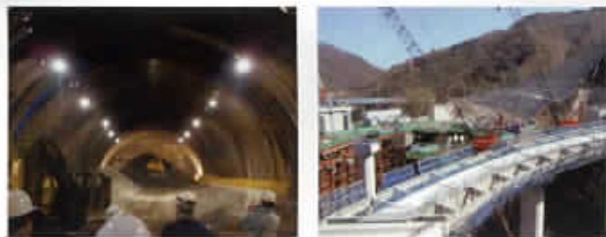
工事が進む中部横断自動車道 (左:一色トンネル 右:下部温泉ランプ)
