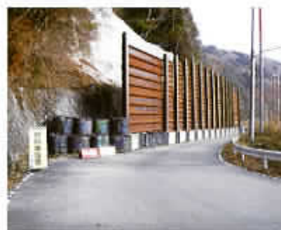
平成23年12月に土砂崩落した県四尾連湖公園線
